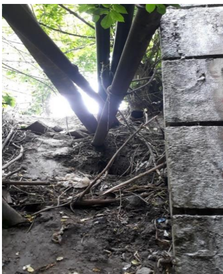
Рисунок 3.18. Незаконно встановлена труба
