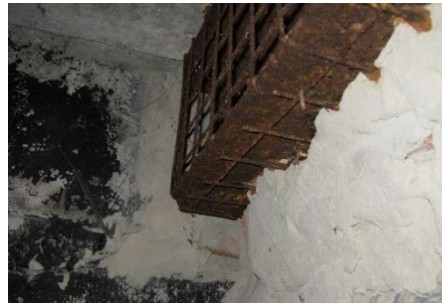
Рис. 6. Ексцентричне розміщення, зім'яття опорної частини фундаменту металевої балки 2 Т №27Са – ряд Е, вісь 29
