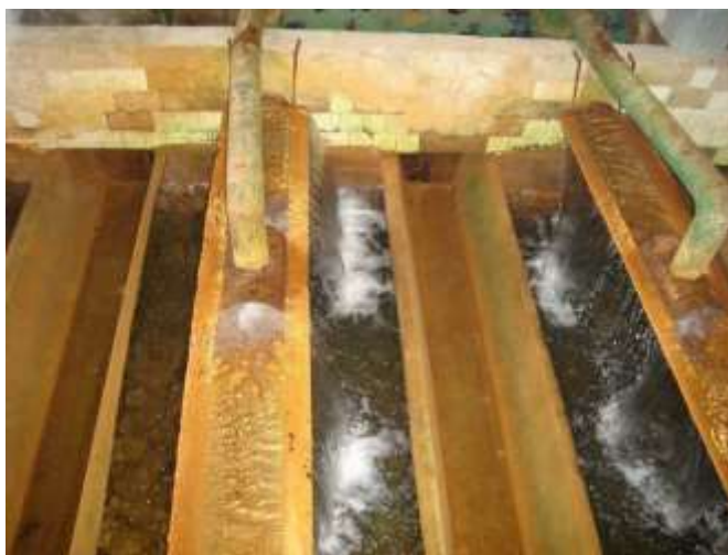
Рис. 3.7. Технологічний процес на станції знезалізнення води (вигляд вздовж лотків)
