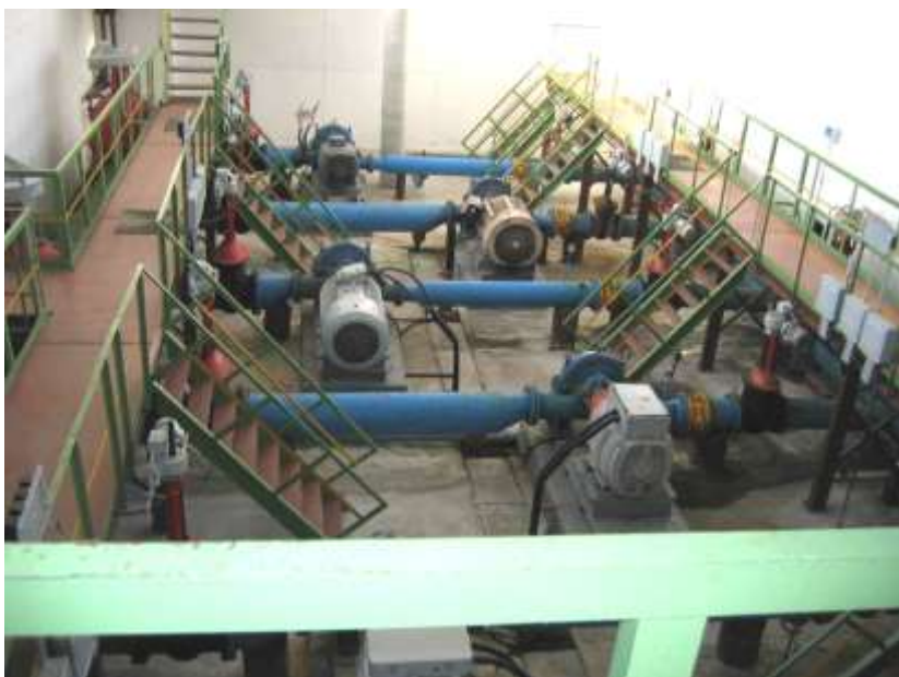
Рис. 3.4. Водопровідна насосна станція
