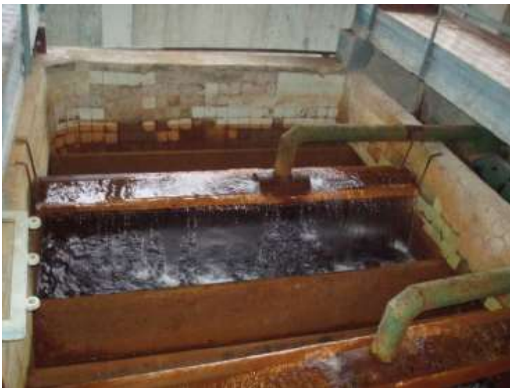
Рис. 3.8. Технологічний процес на станції знезалізнення води (вигляд з боку, відносно лотків)
