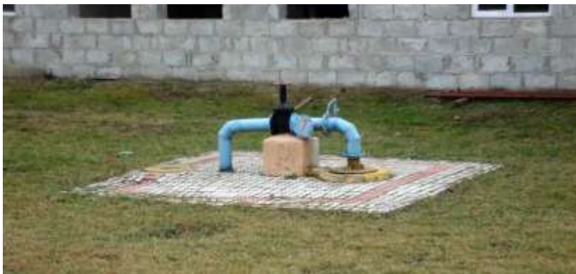
Рис. 3.3. Наземна частина водозабірної свердловини
