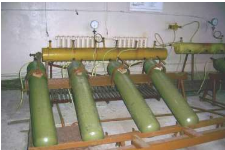
Рис. 3.9. Установа для забору хлору з балонів на станції хлорування
