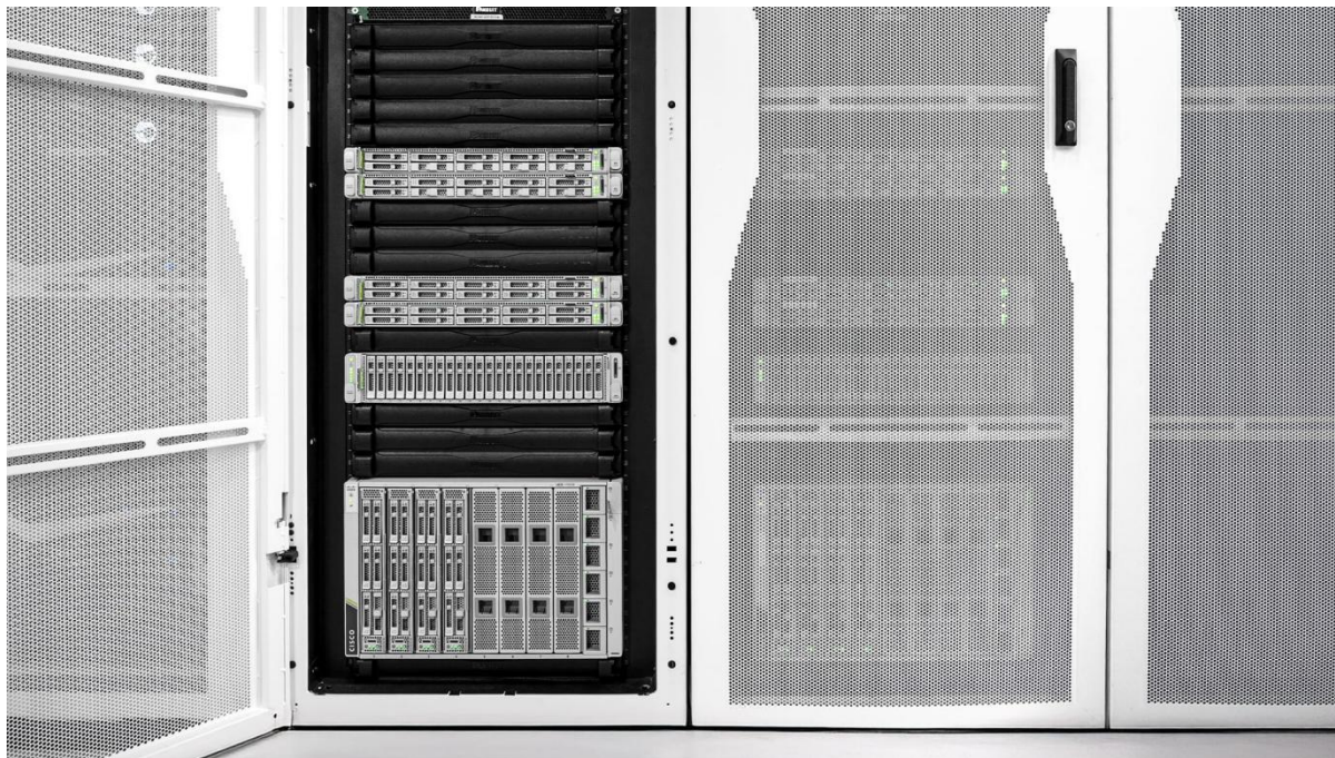
Рисунок 1.1 – Приклад серверної кімнати з серверними стійками [7]
