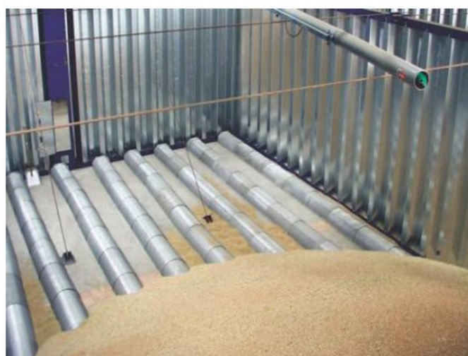
Рисунок 1.6 – Система вентиляційних каналів у зерносховищі, через яку проводиться знезараження зерна озоном
