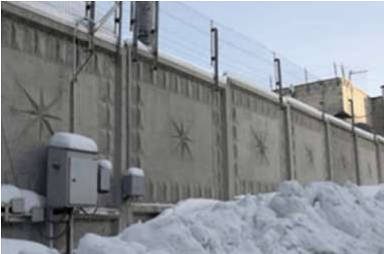
Рисунок 2.2 – Зовнішній вигляд ємнісного засобу виявлення, який встановлено на залізобетонному паркані
