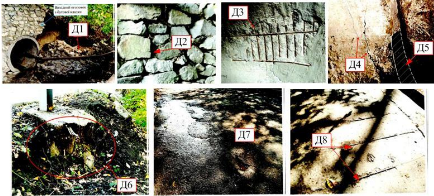
Рис. 1. Дефекти та пошкодження конструктивних елементів
