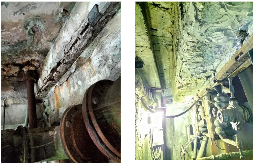
Рис. 2. Фотофіксації з обстеження шинної балки
