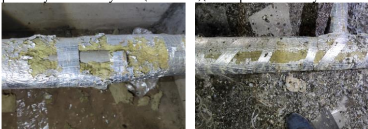
Рис. 5. Ушкодження шару утеплювача
