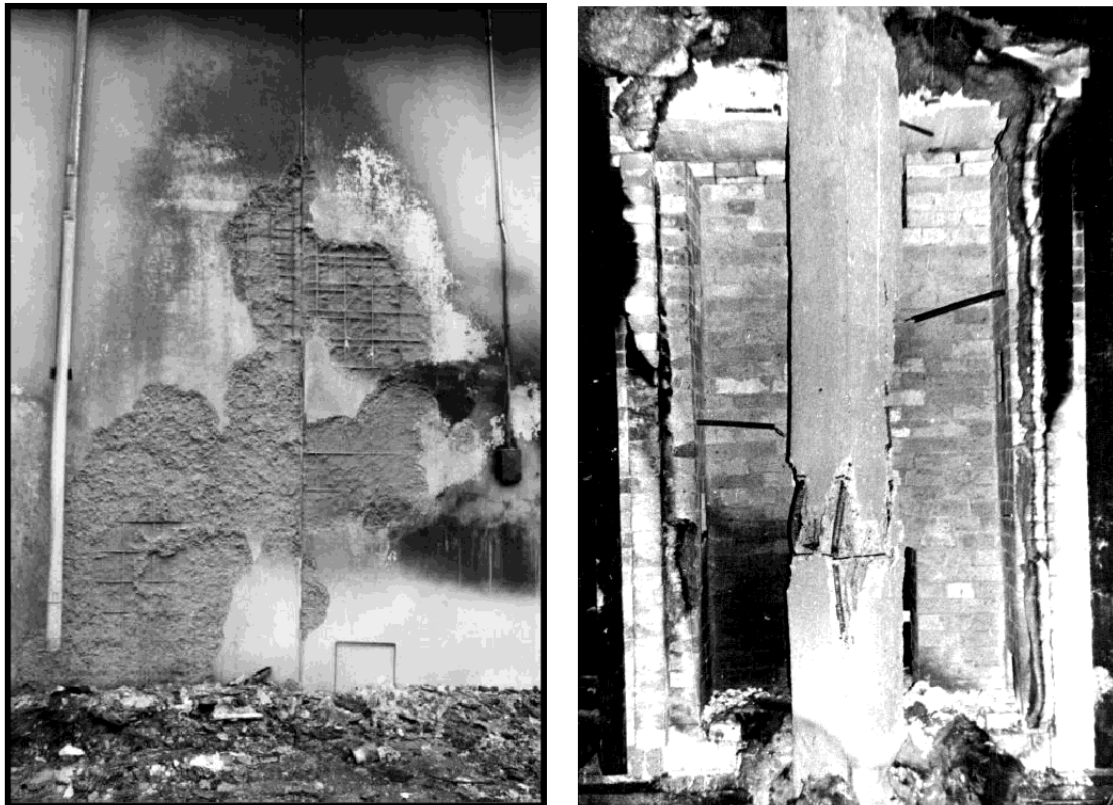
Рисунок 6.2 - Ушкодження залізобетонних конструкцій під час пожежі.
