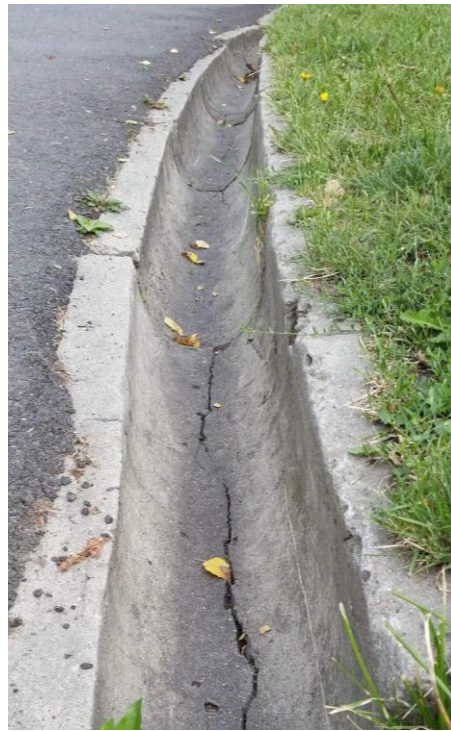
Рисунок 7.14 – Пошкодження бетонних водовідвідних лотків для відведення дощових і талих вод у центральному парку імені Лесі Українки м. Луцька
