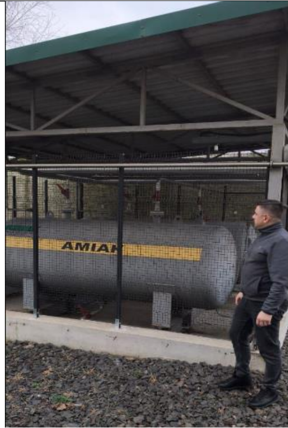
Рисунок 2.8 Резервуар для зберігання аміаку
